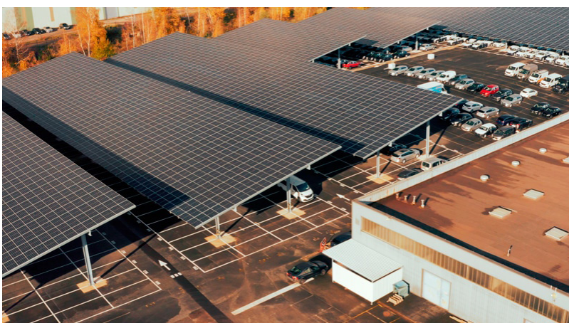
Forbach (57) - ombrières photovoltaïques
