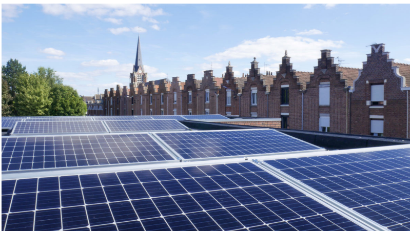
Pérenchies (59) - opération d'autoconsommation collective multi-acteurs, production locale de l'énergie en circuit court
