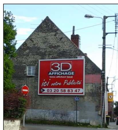
Publicité murale avec hauteur max qui dépasse l'égout du toit
