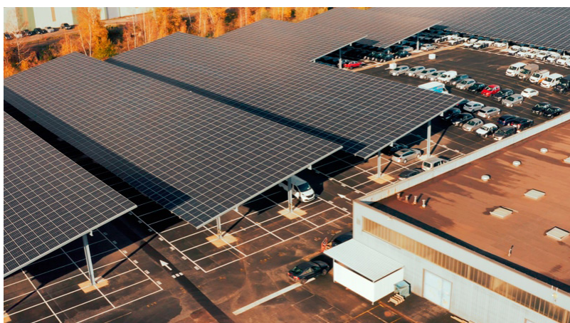
Forbach (57) - ombrières photovoltaïques
